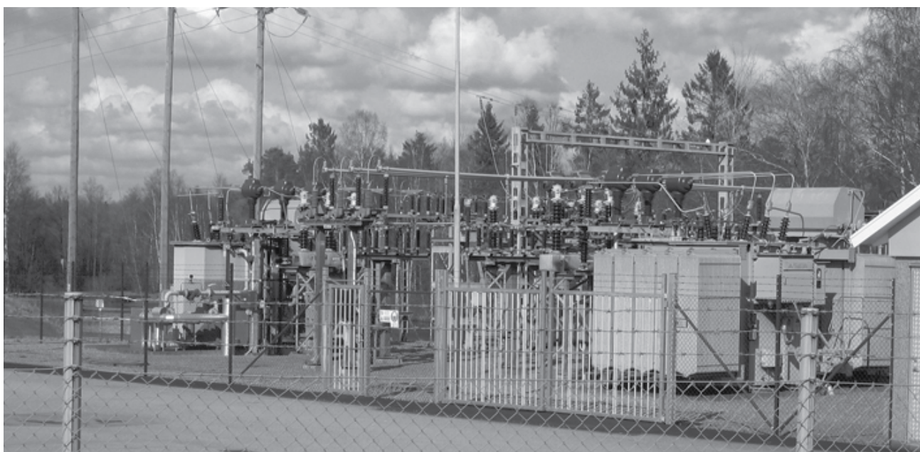
Ställverk vid Mossarp
