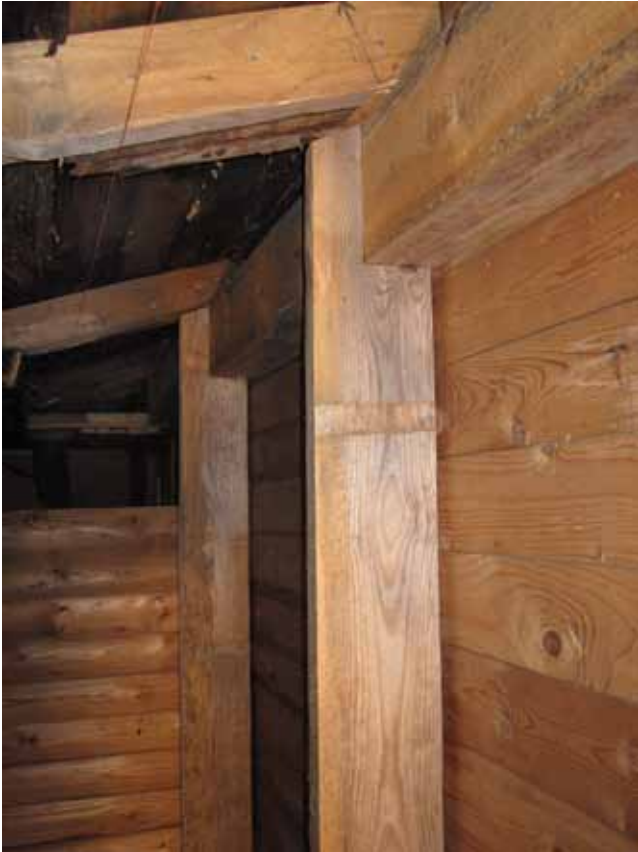
Avbäringen för de rötskadade takbjälkarna bakom verkstadsrummet mot såghuset till, vilar på brädor med urtagna hak. I bildens övre vänstra hörn skimtar snöret som nyttjades för att rikta de nya taktassarna.
