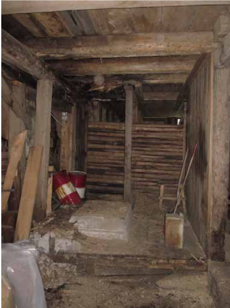
Det inre rummet under arbete, mellanväggarna är delvis demonterade för att komma åt skadorna.
