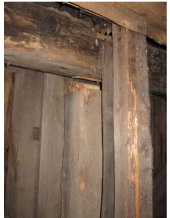
Golvet hade satt sig, vilket gjorde att vissa av mellanbjälkarna saknade sitt stöd, då den ihakade stolpen hade sjunkit så mycket att den hade fallit ur haket.
