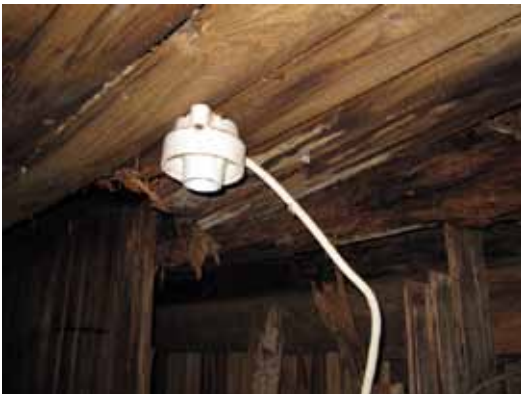
Detalj rötskada i taket källarplanet.
