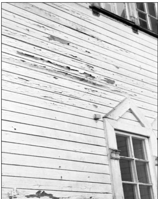
Färgen flagnade i stora sjok på hela fasaden.
