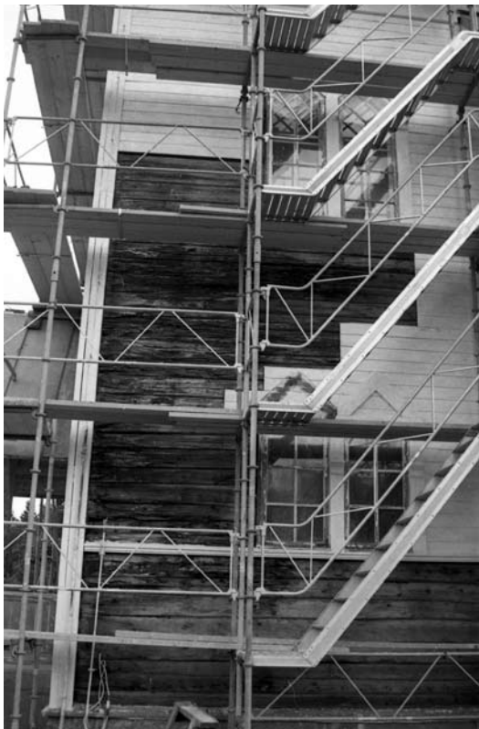
I ett större parti på tornets västra sida var både panelen och timmerstommen rötskadad.
