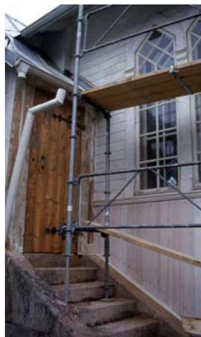
Vid sakristians trappa hade bröstpanelen rötskadats och byttes därför. Bräddörren har gjorts helt träen.
