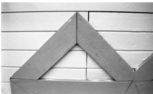
Exempel på panellagning med dålig precision i skarvningen.
